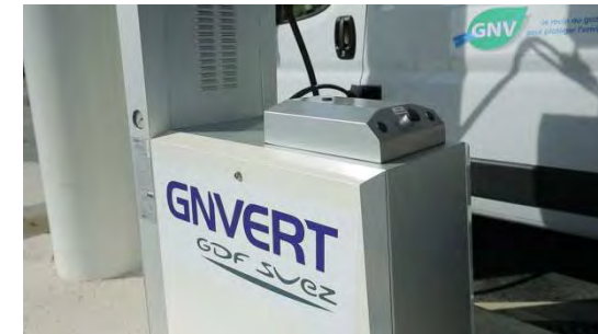
Station GNL/C de Rungis GNVERT
